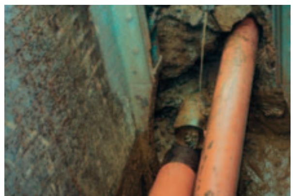
Spülkopf vor dem Einzug ins Erdreich (links: einzuziehender Rohrstrang, rechts: Rohrstrang aus vorheriger Halterung)
