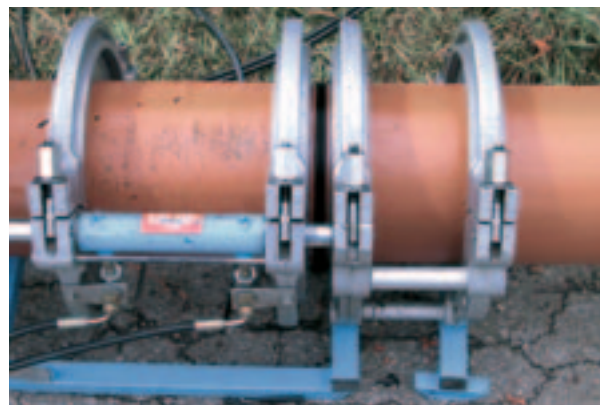
Verschweißen der Rohre im Heizelementstumpfschweißverfahren (HS). Die Verschweißung erfolgt gemäß DVS Richtlinie DVS 2207, Teil 1.
